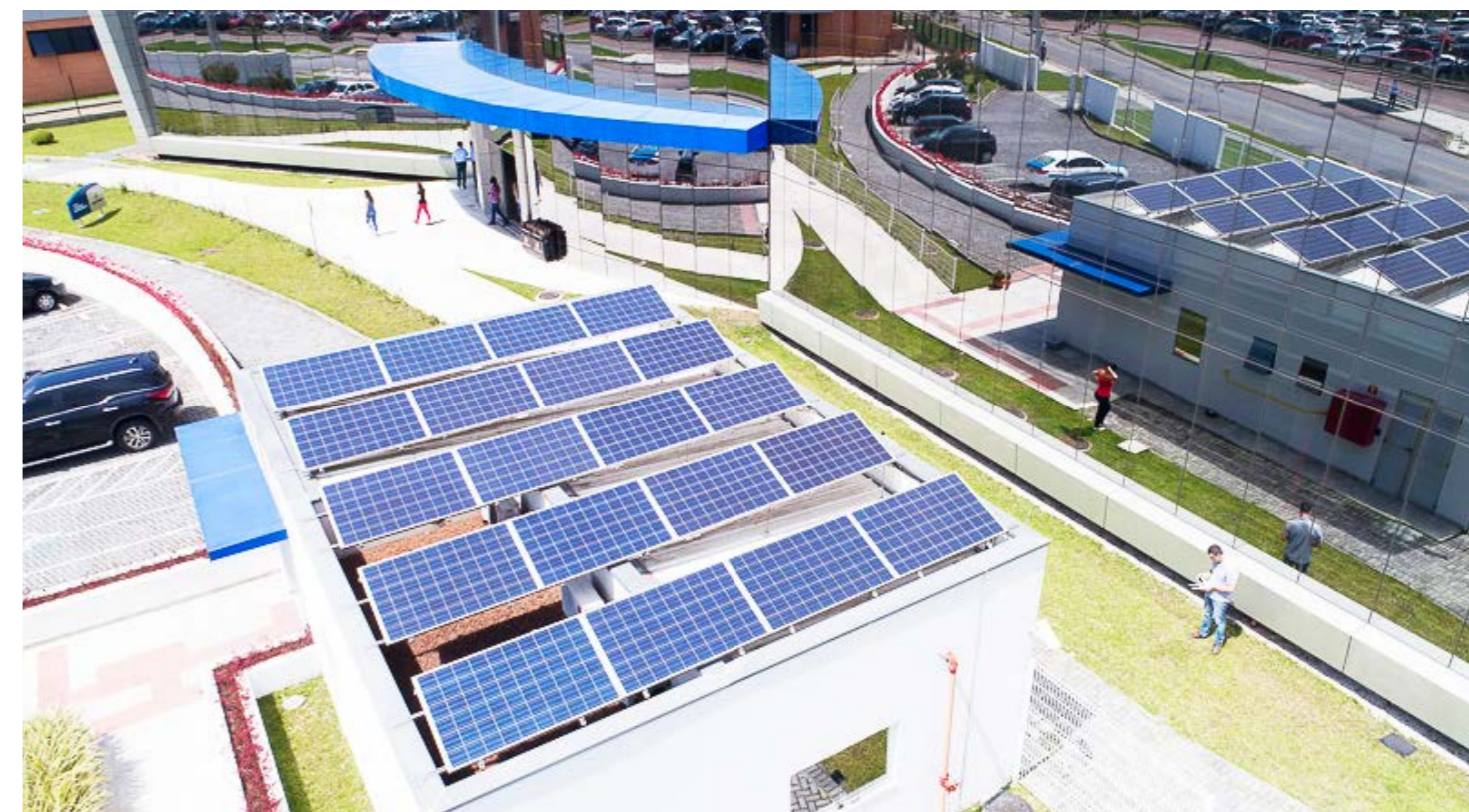
Placas solares na planta de São José dos Pinhais (PR)
