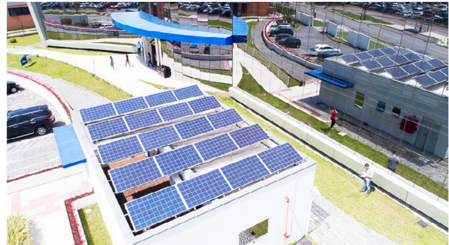
Paneles solares en la planta de Sao José dos Pinhais (PR)
